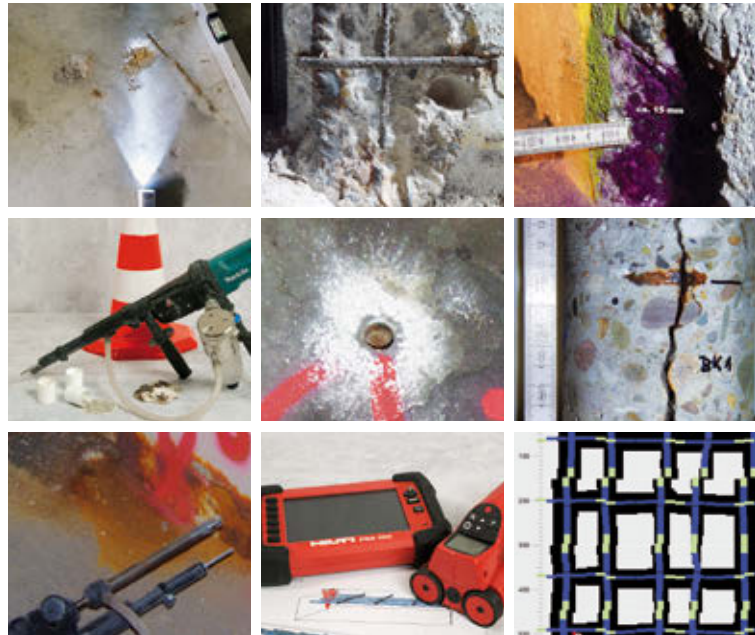
Bei der Schadensermittlung kommen viele unterschiedliche Verfahren zum Einsatz. Diese reichen von zerstörungsfreien Messverfahren wie beispielsweise der Betonüberdeckungsmessung bis hin zu Bauteilöffnungen.
