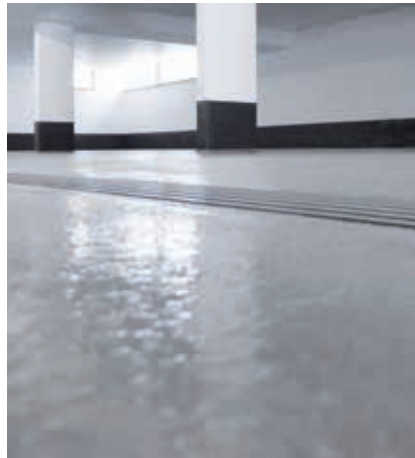
Kunststoffrinnen von MEA liegen boden- eben im Belag und bieten viele Vorteile.
