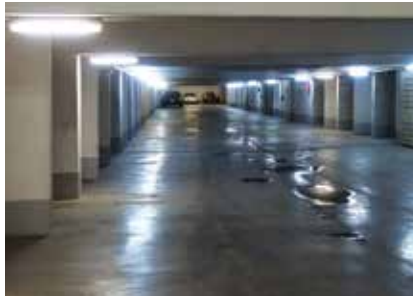
An der Tiefgarage in Blaustein hatte der Zahn der Zeit genagt. Aufgrund fehlender Oberflächenschutzmaßnahmen konnte tausalzhaltige Feuchtigkeit in den Beton eindringen, was zu vielfältigen Schadensbildern führte.
