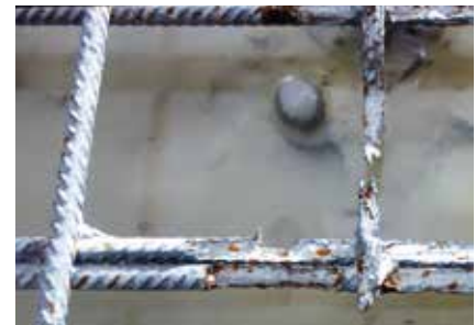
Bewehrungen mit Querschnittsverlusten von bis zu 80% durch Lochfraßkorrosion.
