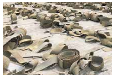
Als erstes mussten im Zuge der Sanierung die alten Deckschichten abgeschält werden.
