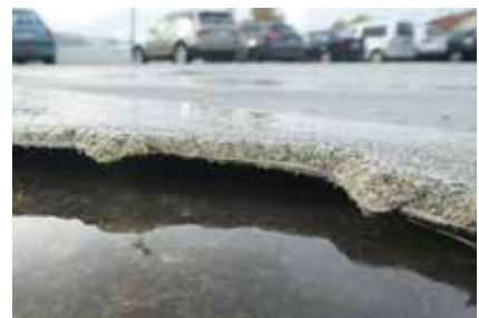
Unter den abgelösten Deckschichten hatte sich Wasser angesammelt.
